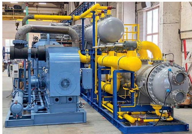
Холодильная установка, выполненная для завода специального назначения (химическая промышленность)
