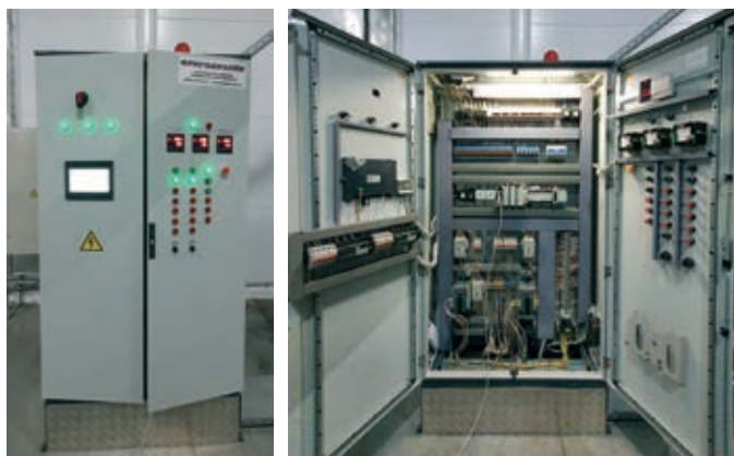
Шкаф системы управления оборудованием климатической камеры
