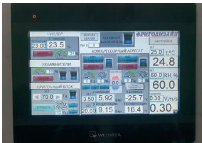
Экран информационной панели шкафа системы управления и мониторинга
