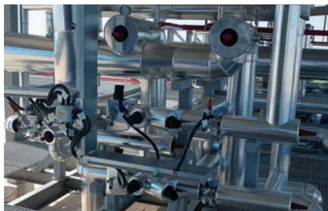
Рис. 2. Распределительное устройство обвязки испарителя в теплоизоляции
